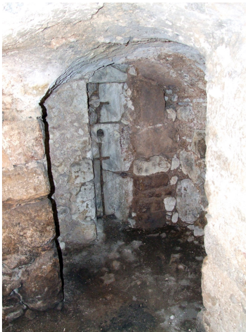
Fig. 14a. Torre del mercato, primo livello: bombardiera verticale vista dall'interno (foto S. Berardis).
